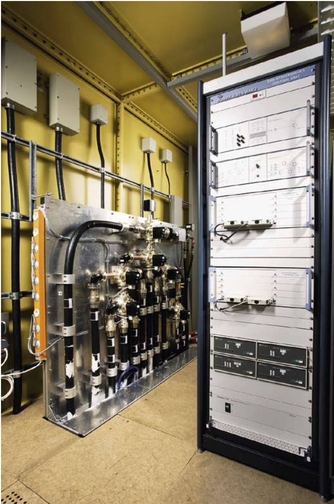
BILD 4 Gestell zum Steuern der Verstärkerumschaltung im Verstärker- raum und im Hintergrund das dazugehörige HF-Leistungsschaltfeld.
