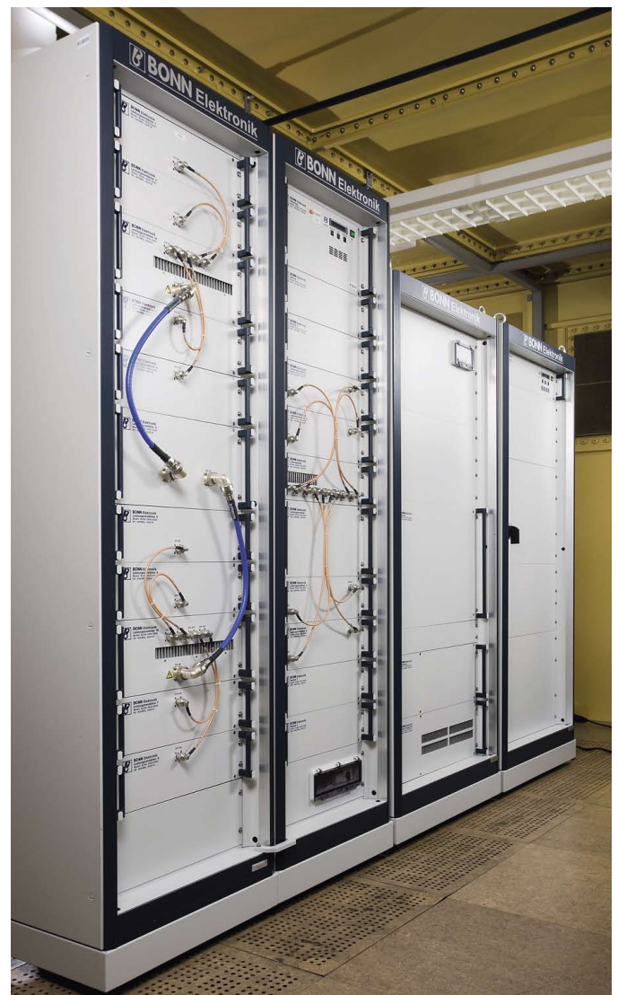
BILD 2 Die Verstärker sind in einem zentralen, abgeschirmten Raum untergebracht und den jeweiligen Messhallen beliebig zuordenbar.
